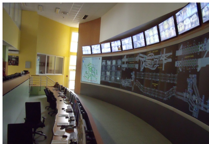
Foto: Celkový pohled na řídicí centrum Brněnských komunikací, a.s. V horní části jsou záběry z kamer, pod nimi jsou plány tunelů a křižovatek.
